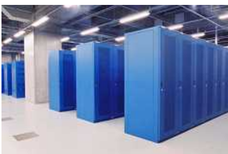
サーバールーム内観
